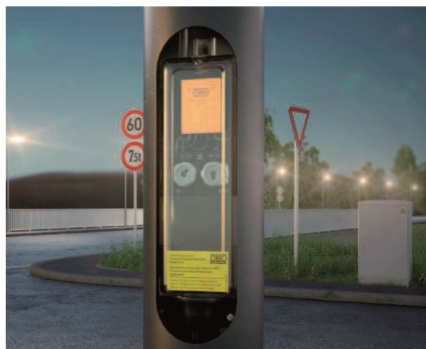
Obr. 4: Svodič ÜSM-10-230I2P v rozvodnici sloupu VO.
